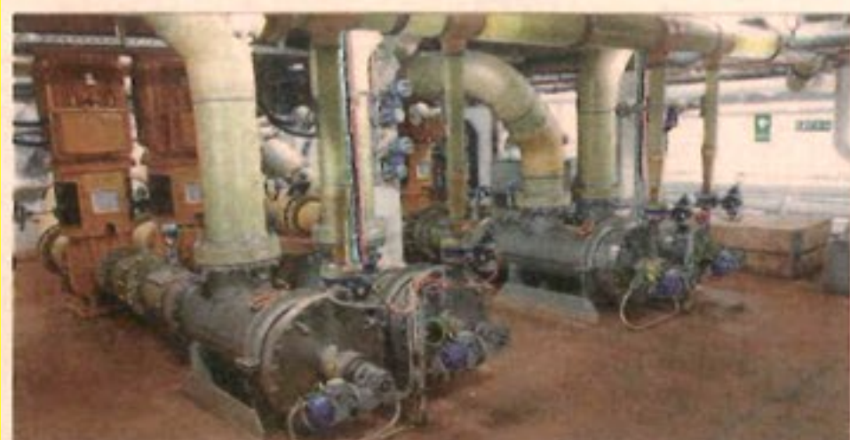
Filtrazione acqua mare impianto EGCS
